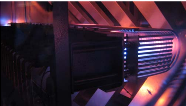
Vista del Quemador HERLO-QHR en funcionamiento
